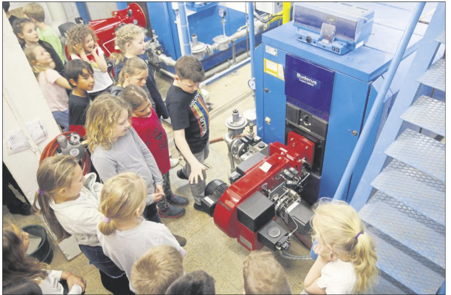
Im Heizraum der Bürgfeld-Gemeinschaftsschule lernen, sehen und hören Schülerinnen und Schüler, wie die Gasheizung funktioniert.
