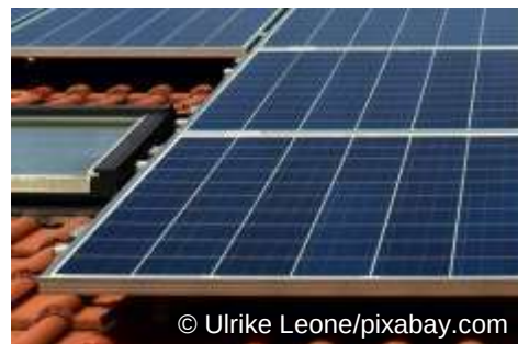
Solarmodul mit polykristallinen Solarzellen
