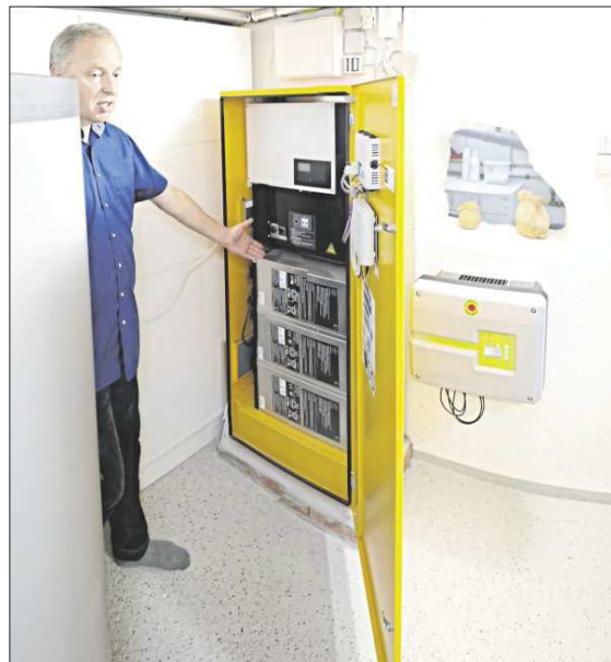
Die energetische Schaltstelle des Hauses: Viel platzsparender als Öltanks oder Pellet-Keller.
