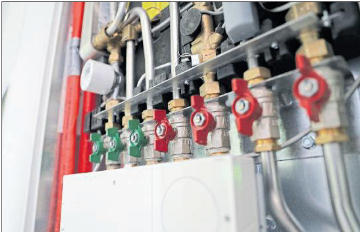
Wo lassen sich unkompliziert Kosten sparen beim Heizen?
